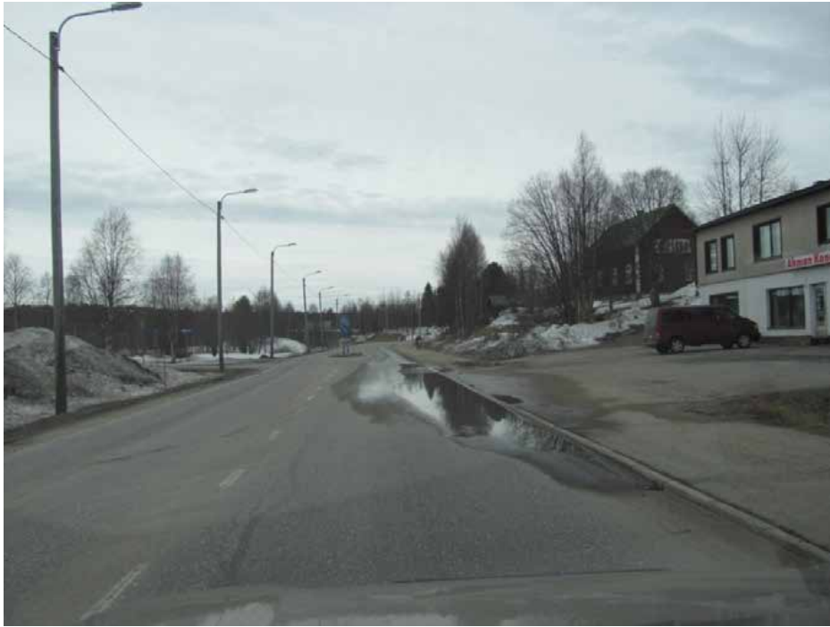
Kuva 42. Talonpojantielle ja kevyen liikenteen väylälle kertyy runsaasti vettä huonosta kuivatuksesta johtuen.
